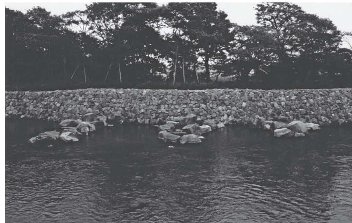
写真①-8 巨石が使われているが、練り石積み工法でつくられているため、 自然にやさしいとはいえない護岸 (撮影：大熊孝)
